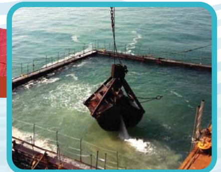
在淤泥屏障內鋪設砂墊層 Laying of sand blanket inside silt curtain
