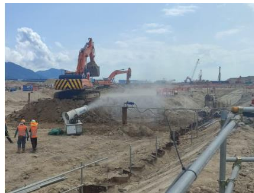
设置 水雾炮 定期向填料洒水
