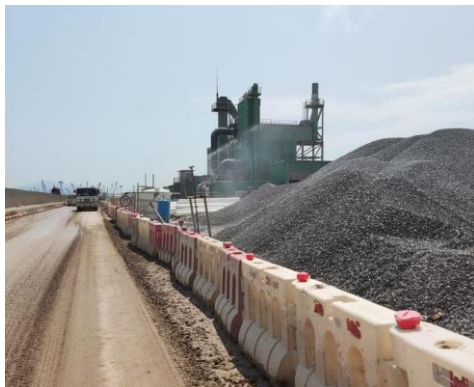
360度自动花洒 定期向填料洒水
