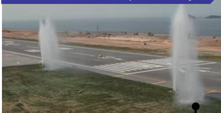
第三跑道旁消防栓(出水测试)
