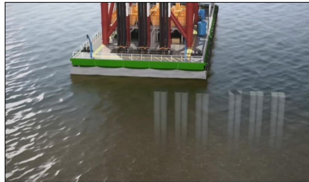
步骤四：凝固后坚硬的深层水泥拌合柱成为新开拓土地的稳固地基
