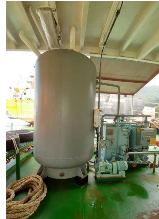
趸船上的生活污水储存缸
