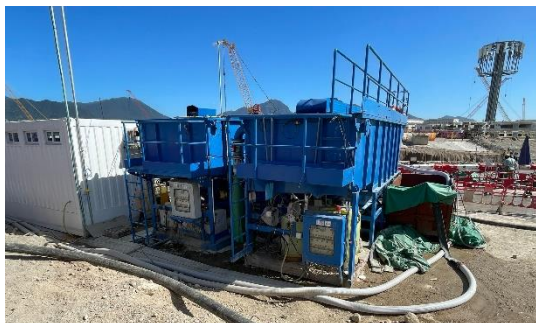
在污水處理設施旁設置大容量沉澱缸以提高處理污水效能
